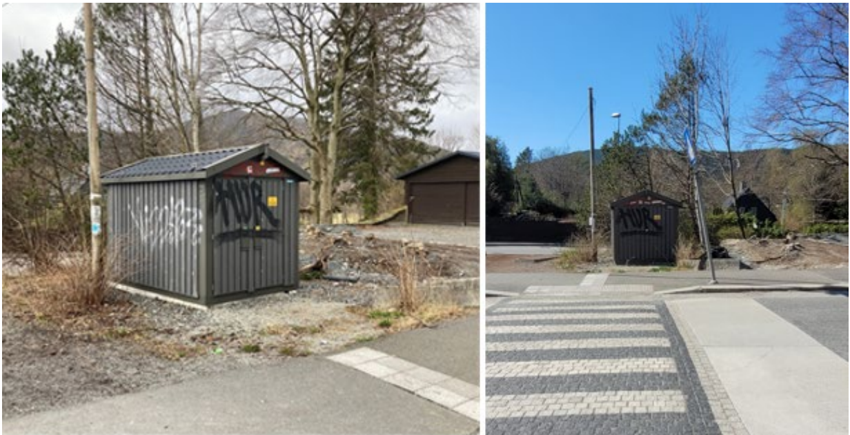
Figur 22: Trafostasjon sør i planområdet.
